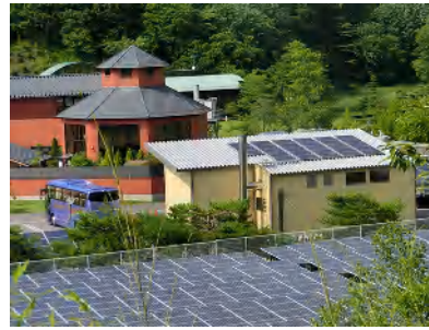
木質チップボイラー施設の屋根にも太陽光パネルが設置されている
