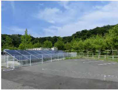
太陽光パネル
